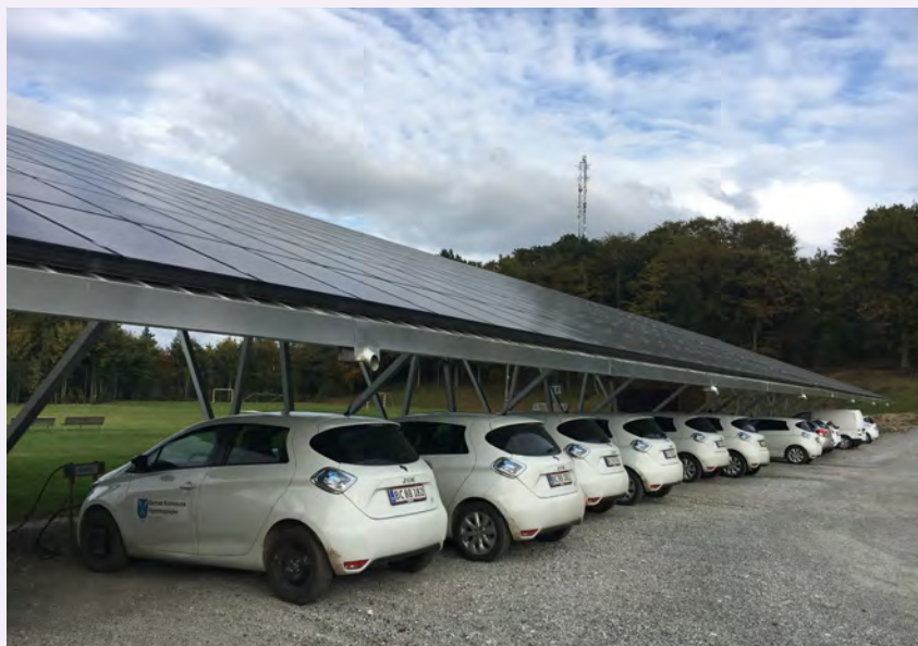
Pv-panelen voor het opladen van elektrische auto's
